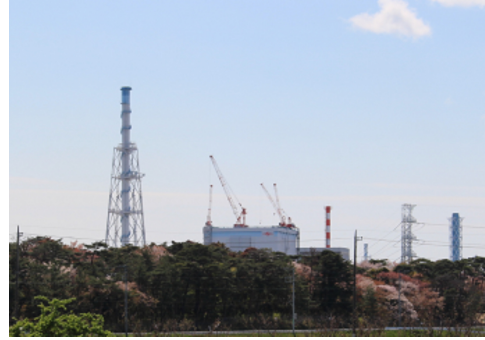
建屋にクレーンが設置された東海第2原子力発電所（東海村より撮影）
